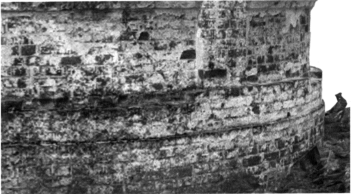
Фото 70 – Алтарная часть. Выступающая относительно стены кладка цоколя
