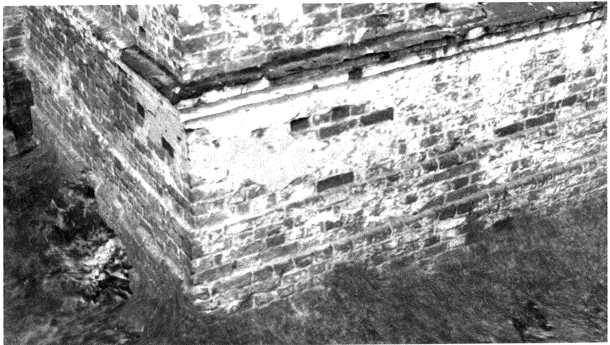
Фото 41 – Трапезная. Южный фасад. Двухступенчатый кладочный пояс с металлическим отливом в уровне подоконников. Выступающая кладка цоколя
