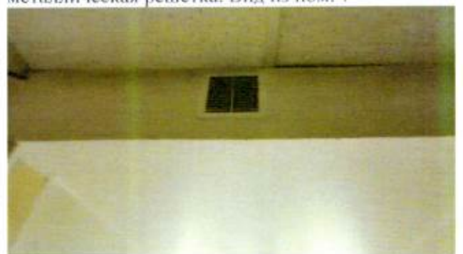
Вентиляционный канал пом.18, 26
