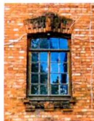
Оформление оконного проема ризалита между 1-ым и 2-ым этажами (ризалиты, восточный и западный фасады)
