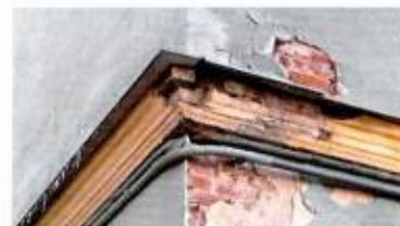
Межэтажный карниз (С-В боковой фасад и С-3 фасад северного ризалита главного дома)
