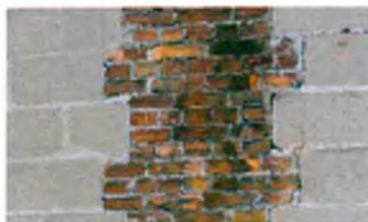
Открытая кирпичная кладка дымохода и кладка из бетонных блоков на брандмауэре дворницкой.
