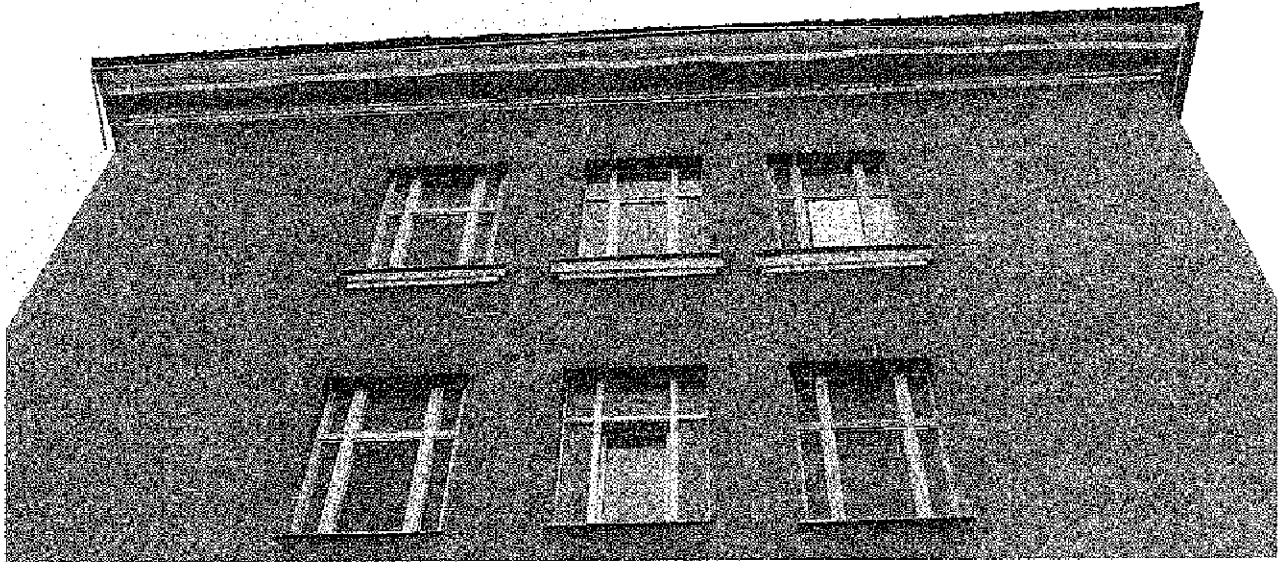
Фото 21. Профилированный венчающий карниз. Западный фасад здания. Дата: 14.07.2021
