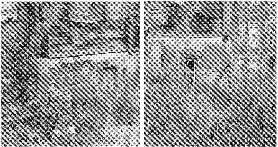
Вид на разрушения цоколя объект культурного наследия (11.11.2022)
