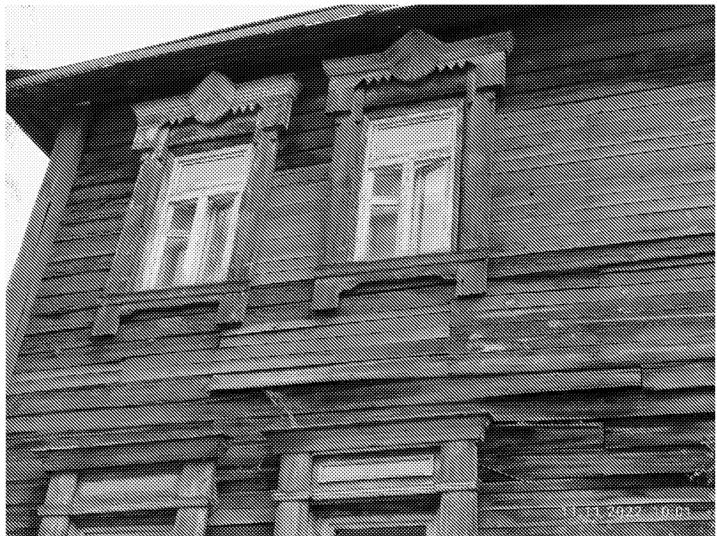
Вид на разрушения фасада объект культурного наследия (11.11.2022)
