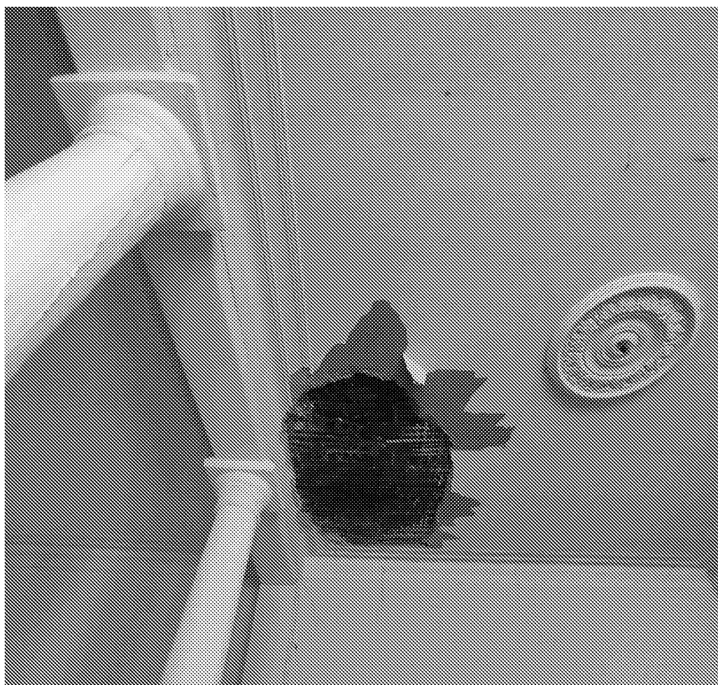
Фото разрушения перекрытия (25.01.2023)
