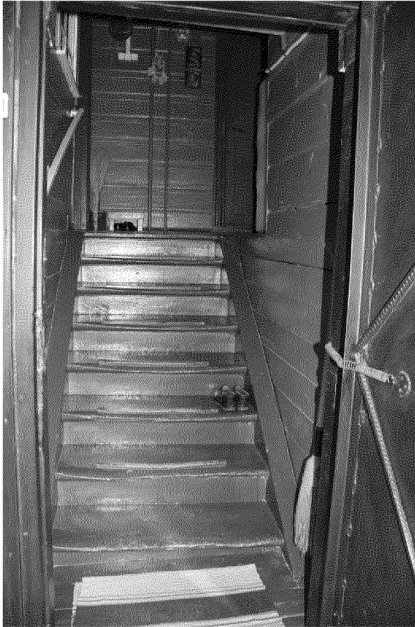
Видовая точка № 13. Деревянная лестница входа в квартиру на 1-й этаж
