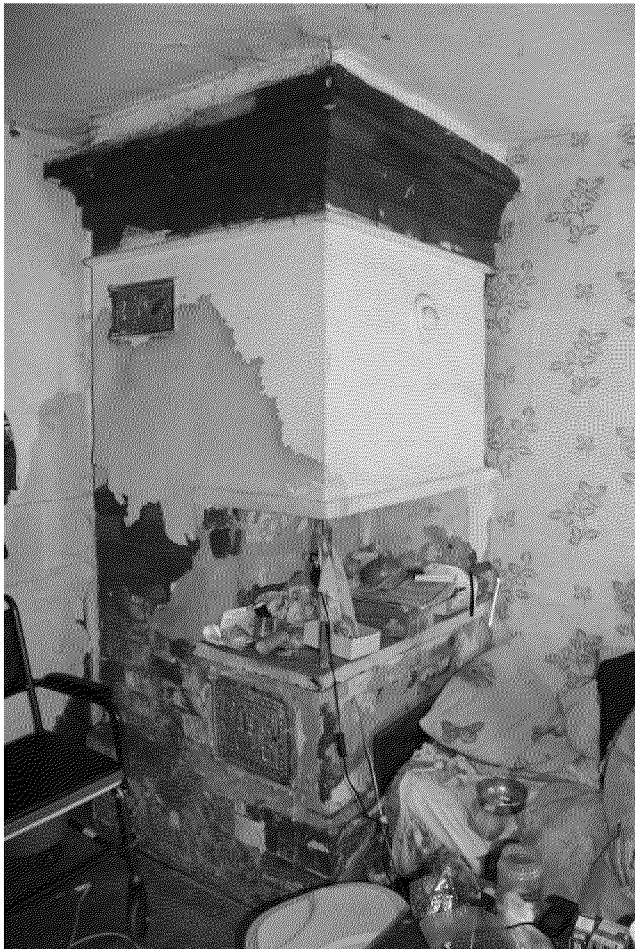
Видовая точка № 23. Печь в квартире цокольного этажа
