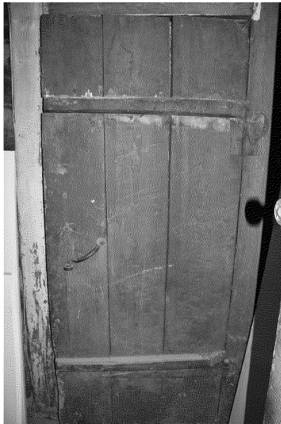
Видовая точка № 11. Дошчатая на шпонках дверь выхода в пристройку в уровне 2-го этажа (Яблонская М.А., 29.07.2024)
